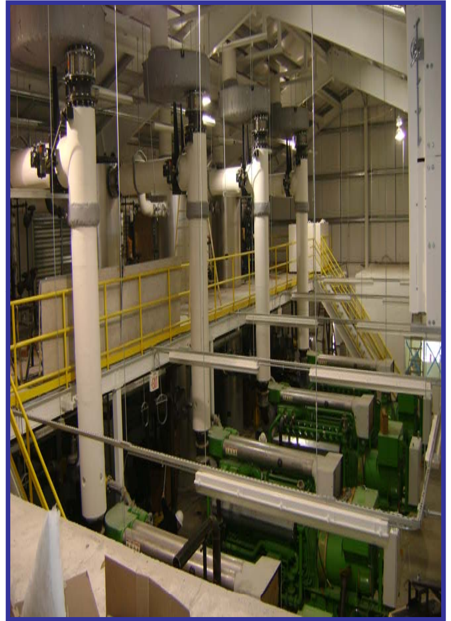
Engines & HRSG at the USCG
